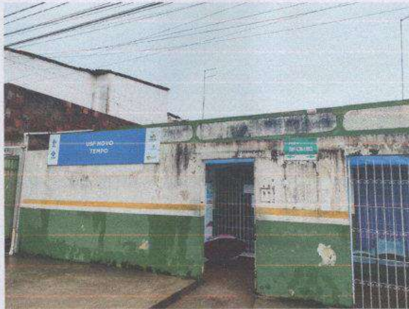
Foto 1. Prédio com fachada abandonada
