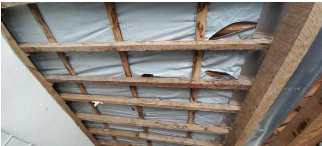
Foto 10. Goteiras na área da cantina
