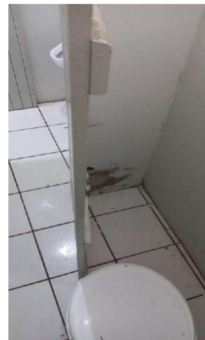
Foto 18. Porta do banheiro masculino não abre e ausência de barra de apoio
