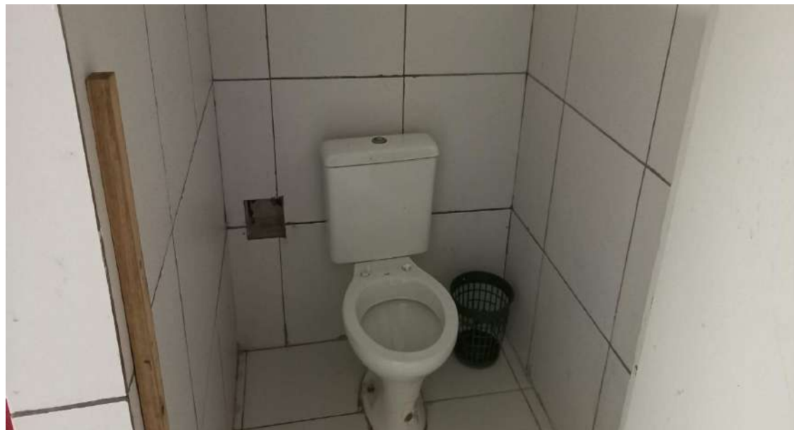
Foto 13. Banheiro sem porta e bacia sem acento
