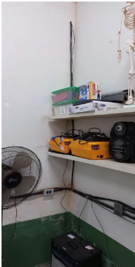
Foto 9. Instalações elétricas da sala de informática expostas
