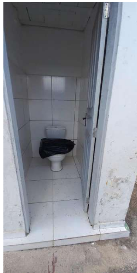
Foto 27. Porta do banheiro sem acessibilidade (estreita e com batente)
