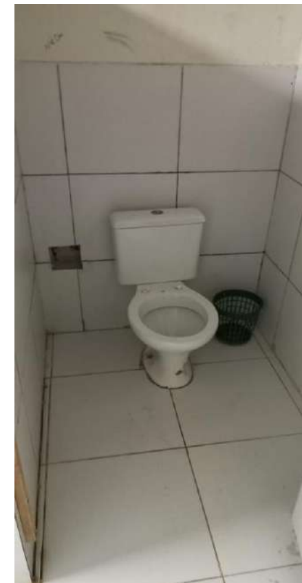
Foto 14. Banheiro masculino sem acessibilidade
