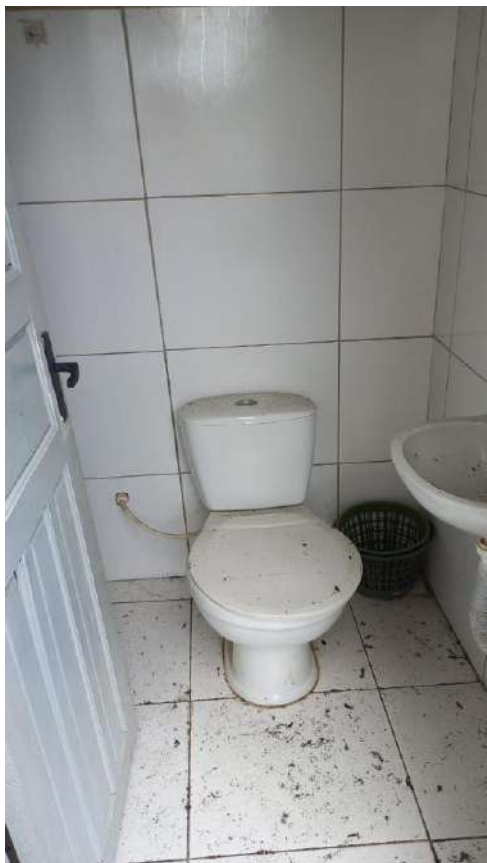
Foto 25. Descarga quebra e sem barra de apoio
