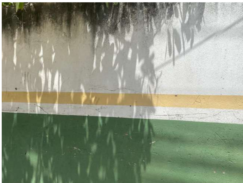
Foto 37. Muro com rachadura e balançando
