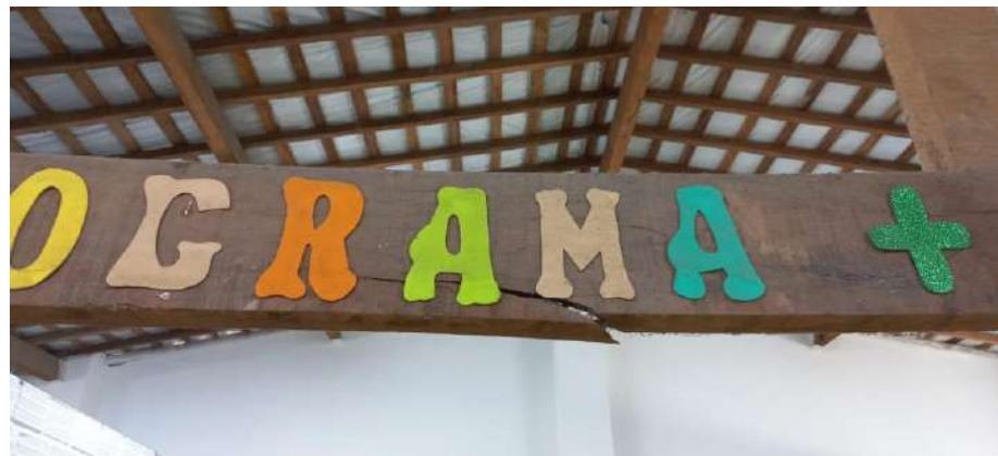
Foto 32. Estrutura do teto danificada
