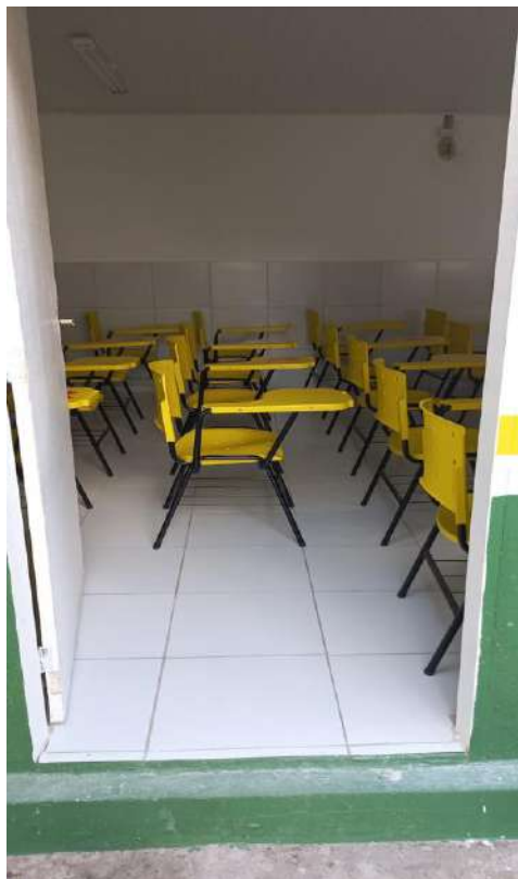
Foto 4. Batente na entrada da Sala e sem rampa de acesso
