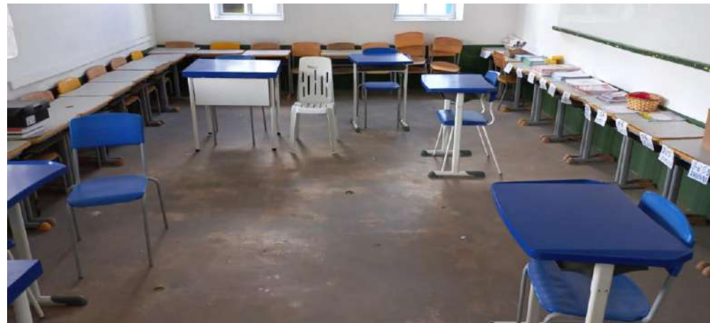
Foto 9. Pisos das salas com buracos
