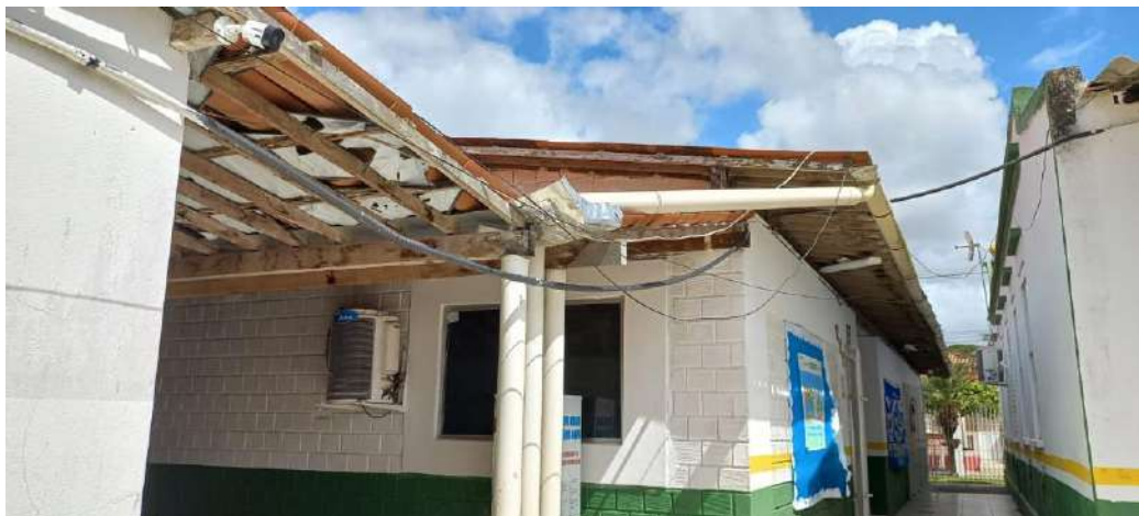
Foto 9. Fiação na área da cantina exposta e parte elétrica com problemas
