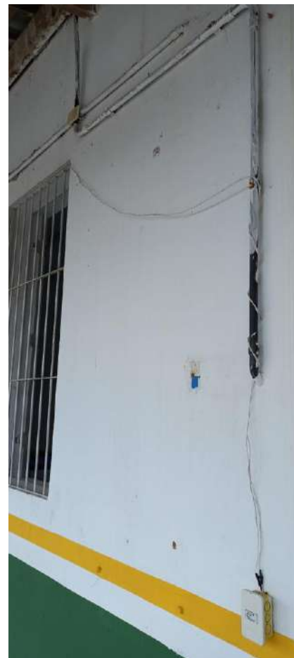
Foto 11. Fiação exposta sem eletroduto
