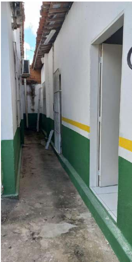
Foto 8. Acesso estreito à Sala de Leitura e sem rampa de acesso
