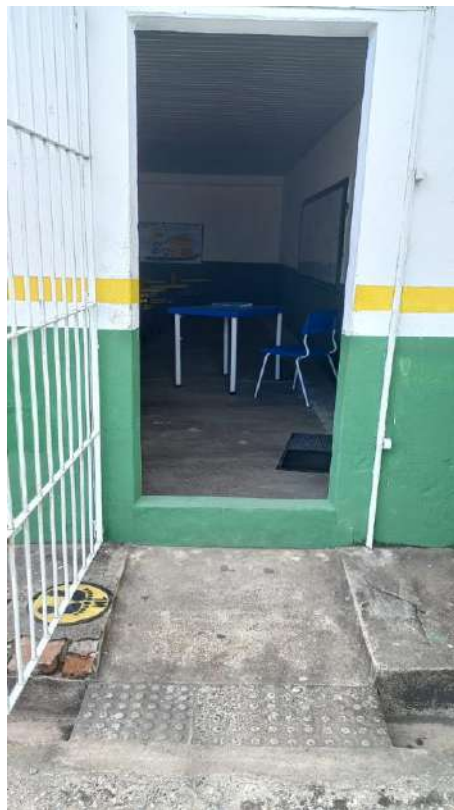
Foto 5. Porta da Sala estreita e sem rampa de acesso
