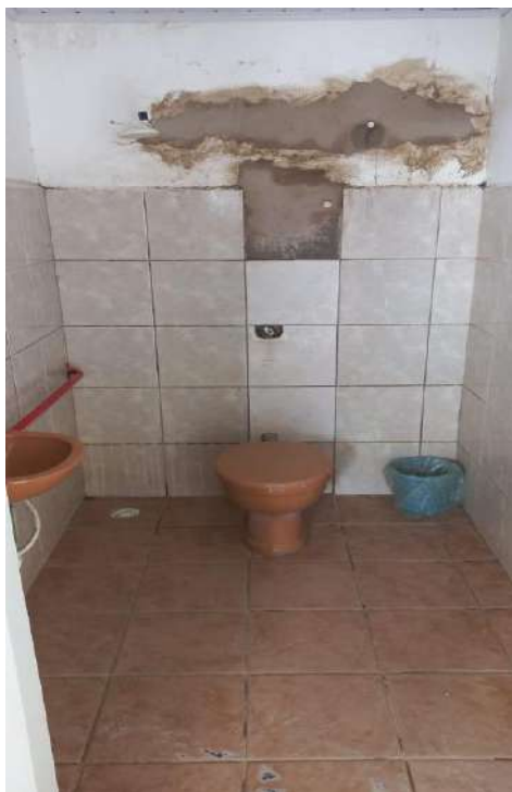
Foto 01. Válvula e cerâmicas danificadas
