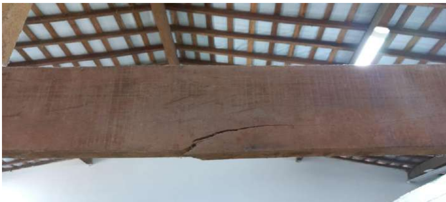
Foto 31. Estrutura do teto danificada
