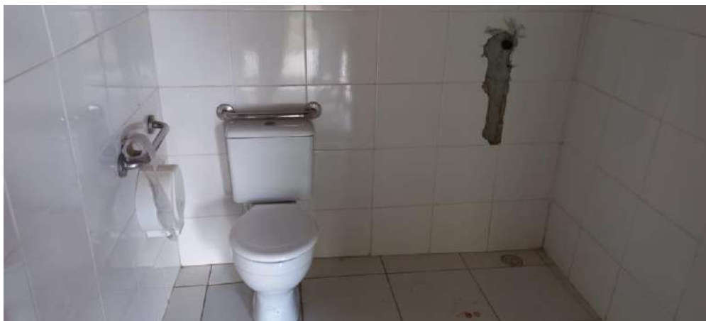
Foto 17. Cerâmica quebrada no banheiro especial
