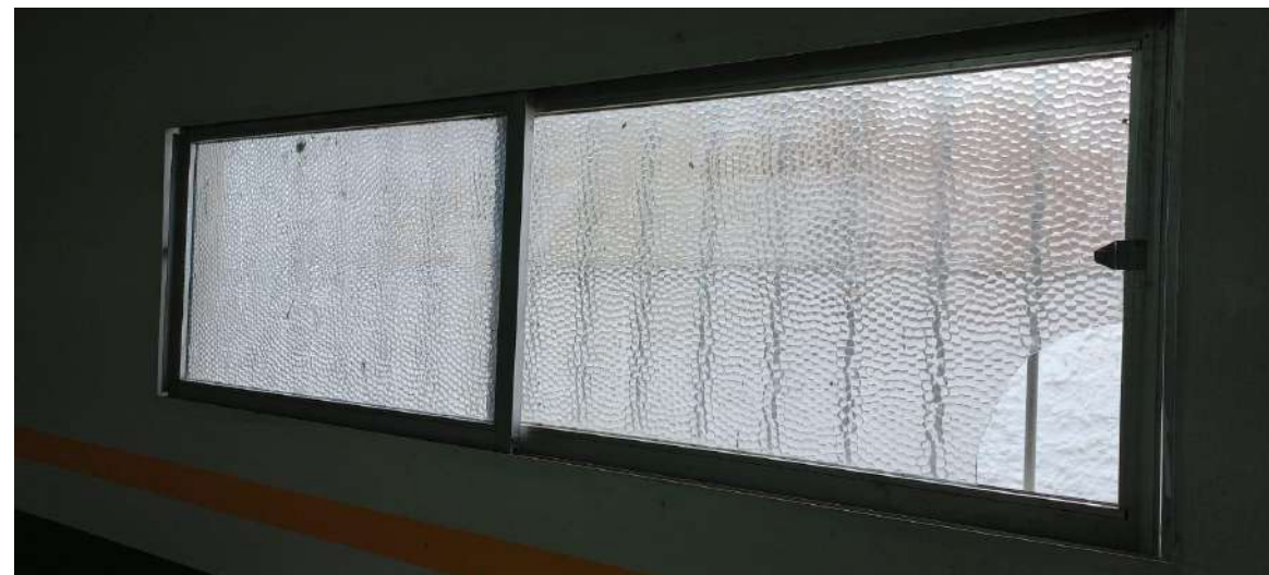
Foto 20. Janela do auditório quebrada
