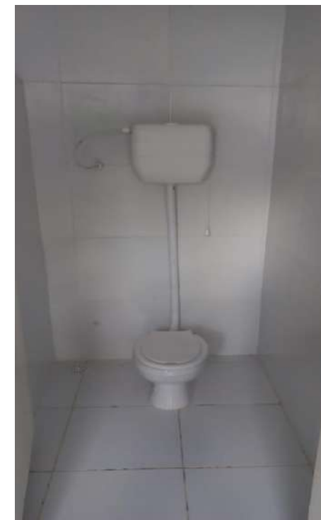
Foto 03. Banheiro sem barra de segurança
