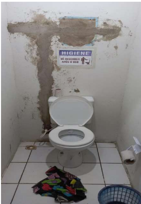
Foto 24. Banheiro sem barra de apoio e com problema na descarga
