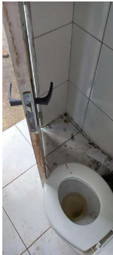
Foto 26. Porta do banheiro não abre
