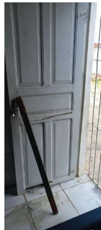
Foto 33. Porta da cozinha quebrada
