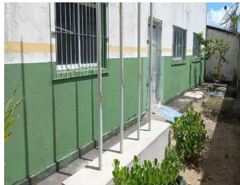
Foto 38. Porta de entrada quebrada
