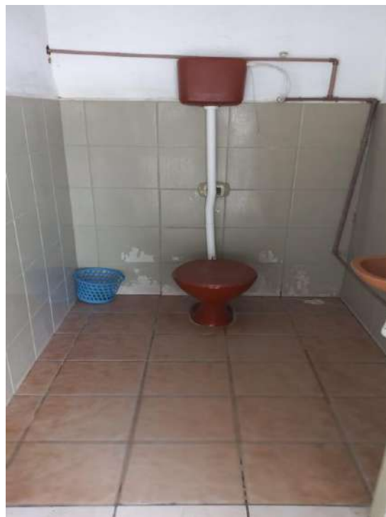
Foto 02. Banheiro masculino sem barra de apoio e válvula quebrada
