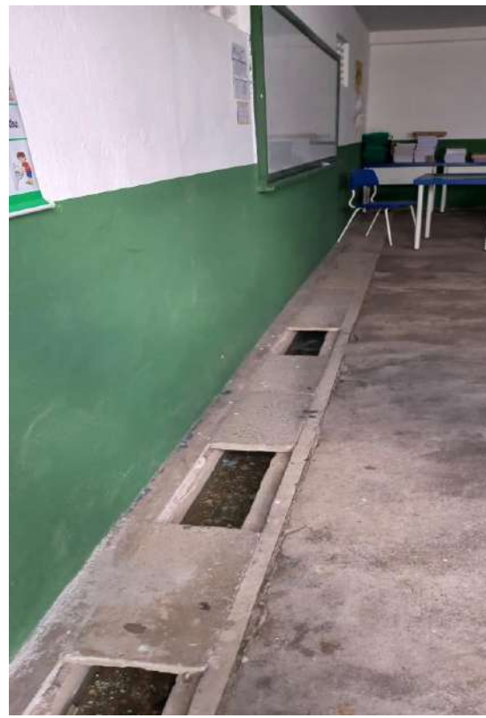
Foto 6. Passagem de esgoto aberta dentro da sala de aula
