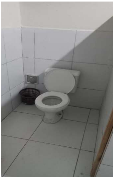
Foto 12. Banheiro de deficiente sem porta e sem barra de apoio.
