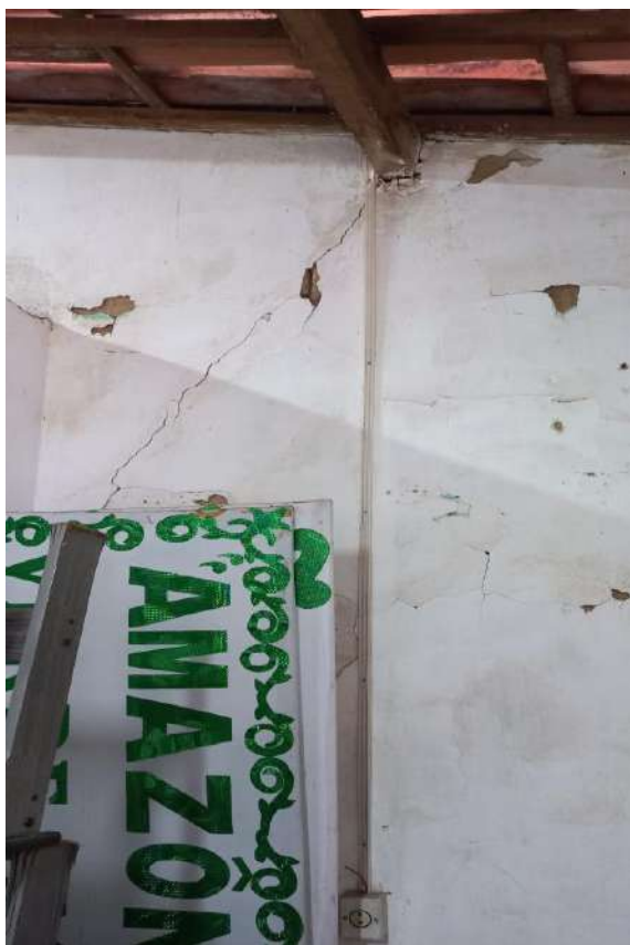
Foto 21. Parede do Almojarifado danificada
