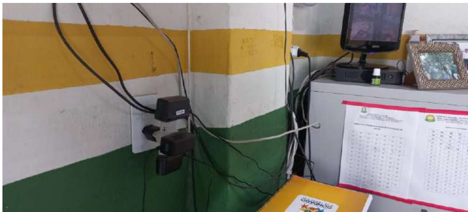
Foto 34. Sobrecarga de tomadas
